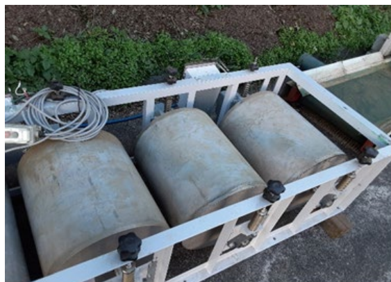
脱水コンベヤのロール
